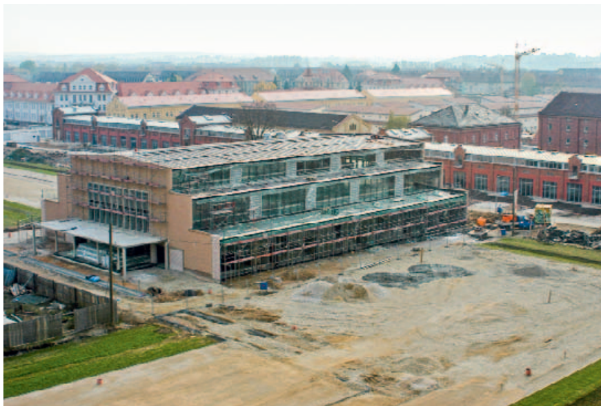
Die ehemalige Turnhalle der US-Army wurde erhalten und in eine multifunktionale Markthalle umgebaut. Fotografien 2003 und 2016.
